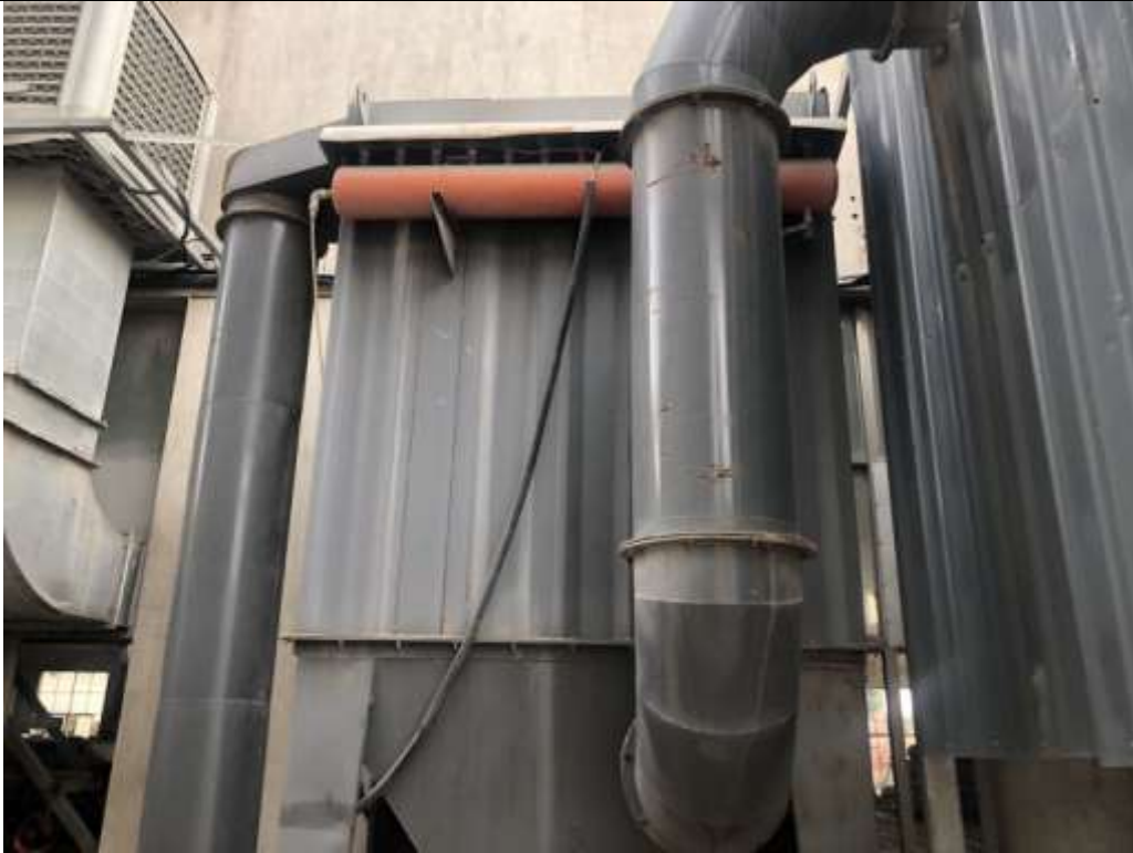
排气筒 FQ-1、FQ-2 进口不满足采样条件，不具备监测条件
