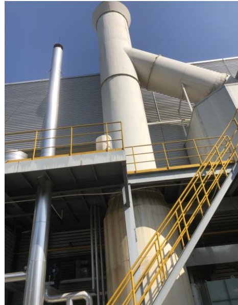
喷漆排气筒及锅炉排气筒（3#、4#）
