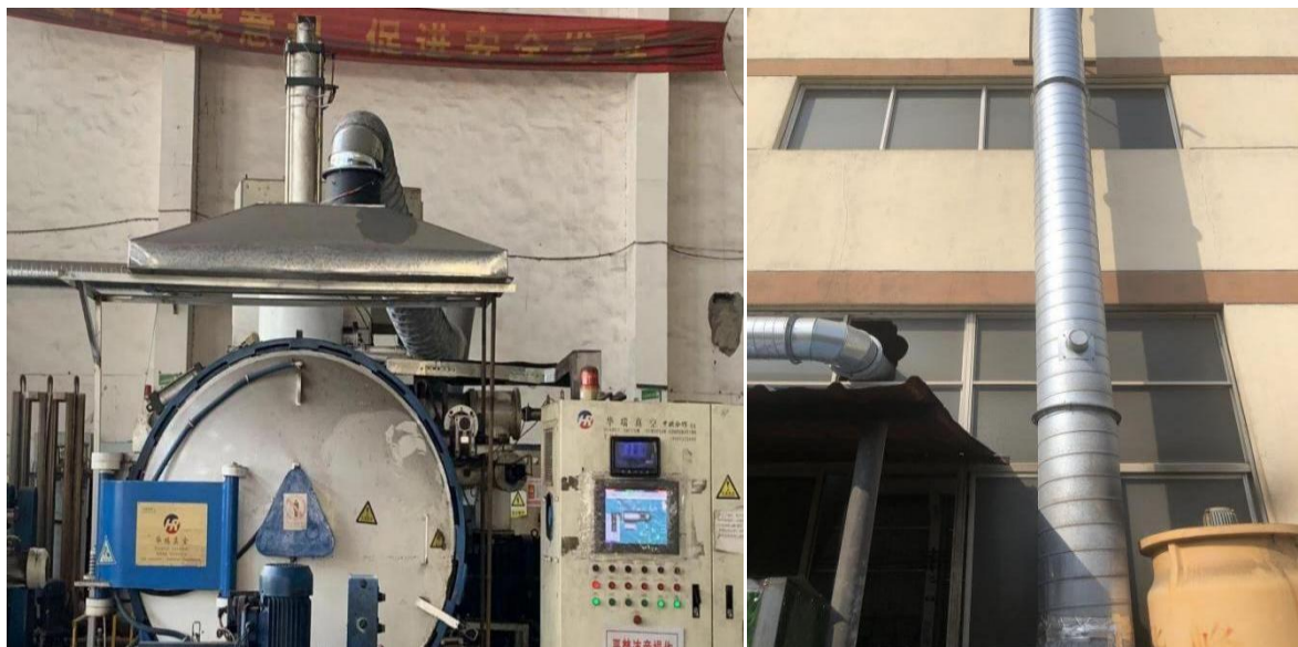
图 4.1-2 废气收集+处理设施图
