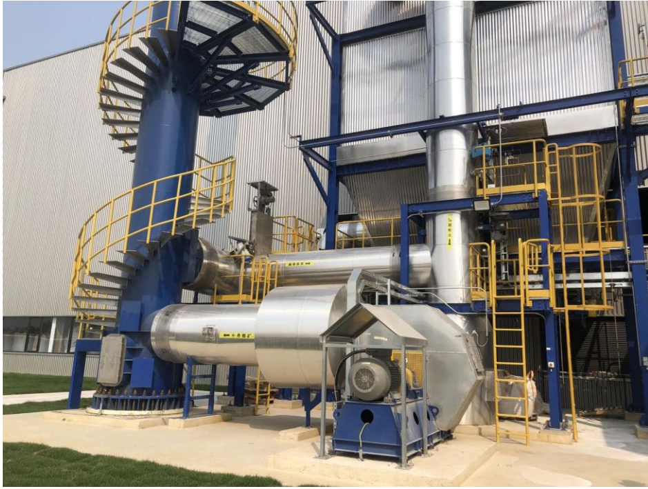
废气设施现场图
